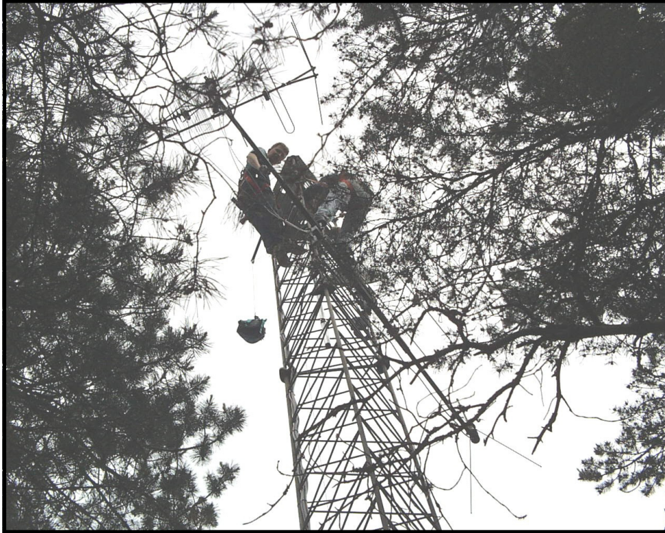
Det gäller att inte vara rädd för höjder. Masten är 24 meter hög och det är tätt mellan trädgrenarna. Som hiss fungerar en ryggsäck. Här ser vi tvärröret som inte sitter allra högst upp i toppen, och som bär upp Räddningstjänstens antenner. Våra är inte på plats ännu vid fotograferingen.
