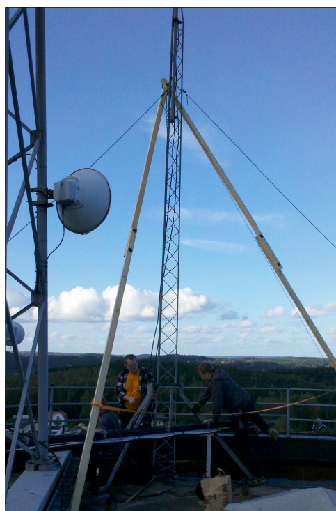
Klart för nedfällning. Comviq's 3G-mast och paraboler till vänster.
